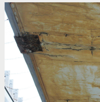
塩害による橋のひび割れ
