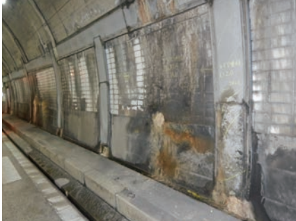
トンネル覆工の劣化状況
